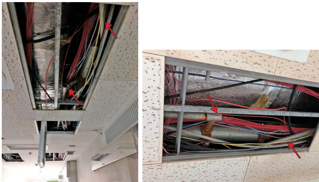
図1 2022年福島県沖地震におけるスプリンクラーの配管破損（国立病院機構宮城病院） スプリンクラーの配管が接続部より損傷している（←）。2018（平成30）年に新たな耐震基準が設けられており、現在はこのような配管構造ではなくなっているが、それ以前の建物は注意が必要である。
